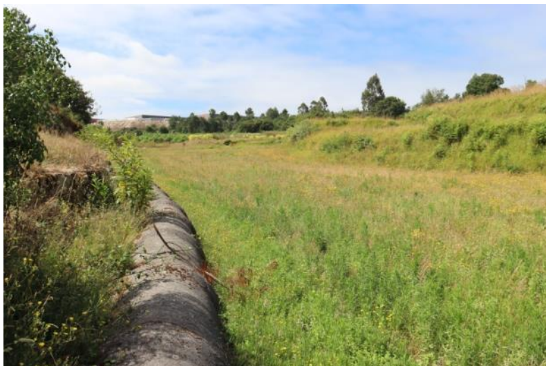
Figura 78 – Entubamento de linha de água no setor oeste da área de estudo.
