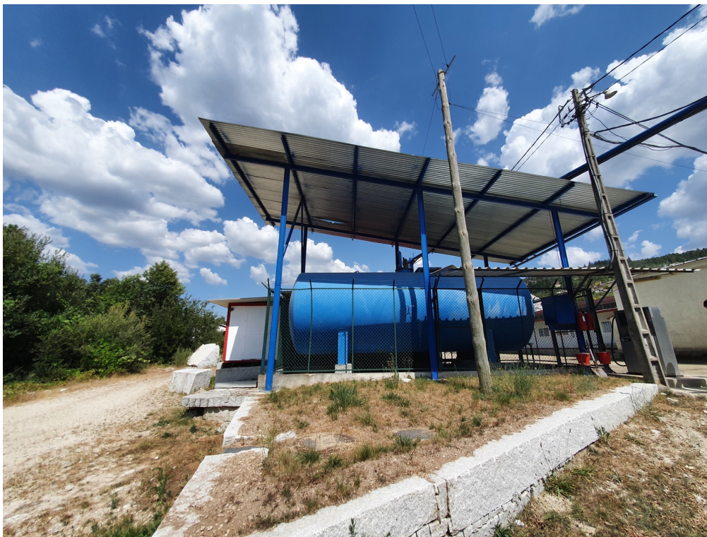
Figura 8: Fotografia do depósito de gasóleo existente nas pedreiras Pedreira n.º 5144 “Soutelinho Novo” e Pedreira n.º 4813 “Ribeiral” (fotografia designada por F7).
