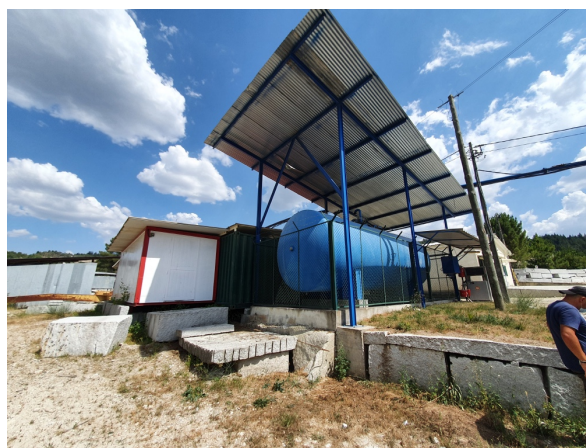
Depósito de gasóleo
