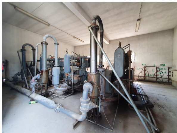
Compressores de ar – Ar comprimido
