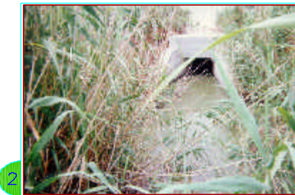
Passagem hidráulica junto ao acesso à ETAR. Destaque para o actual estado de contaminação do água.
