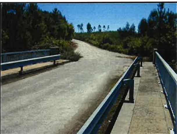
Foto 3: Viaduto sobre o IP5, situado dentro dos limites da zona de concessão, entre as duas áreas de exploração.
