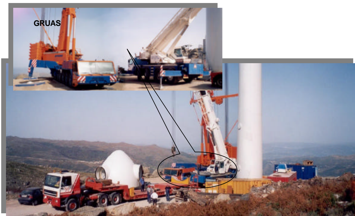
Fotografia 3 – Ocupação e dimensão necessária de uma plataforma para a montagem de aerogeradores de 1800 kW.
