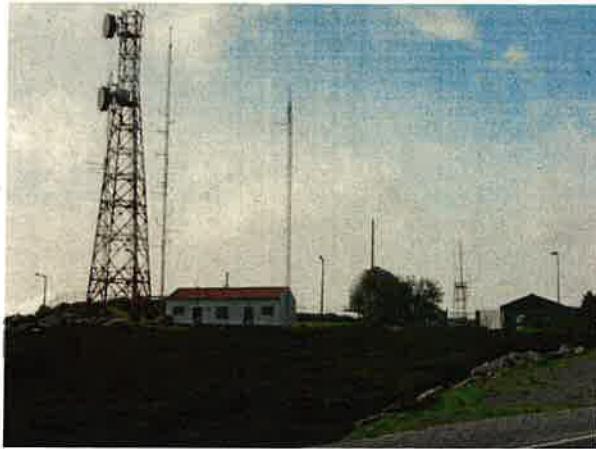
Foto 18 – Antenas existentes na zona da Foia
