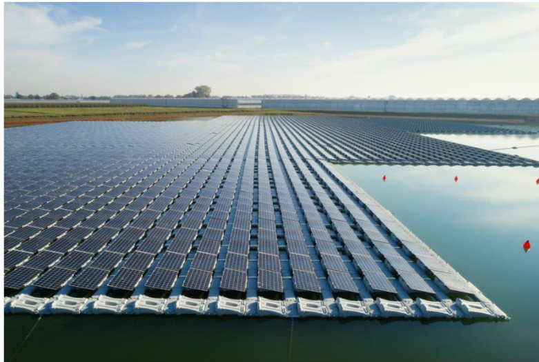
Figura 2 – Exemplo das estruturas colocadas na água com os painéis solares
