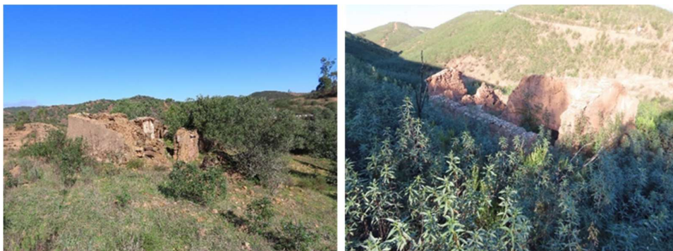
Fotografia 6.16: Foto 1 –Pequeno edifício localizado junto a um caminho, de planta retangular e em elevado estado de ruína. e Foto 2 – Vista geral de um edifício de planta retangular construído em taipa.
