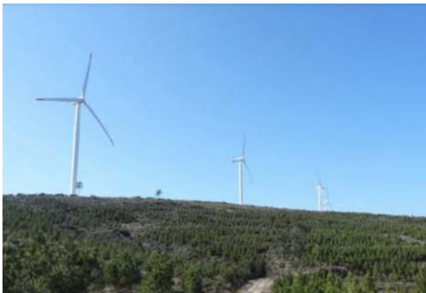
Fotografia 2.1 – Aerogeradores existentes no Parque Eólico do Sabugal
