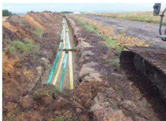
Fotografia 2.16 – Exemplo de uma vala de cabos elétricos
