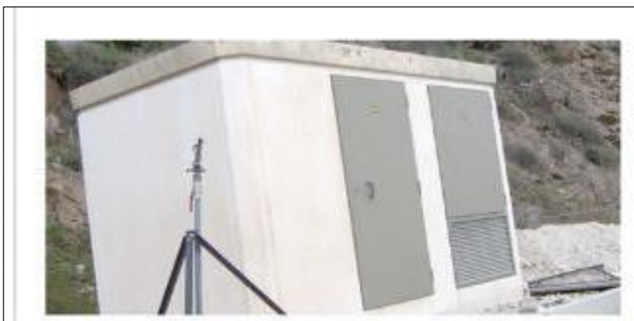
Figura 18 - Linha, Posto de Transformação e Quadro Geral existentes nas antigas instalações
