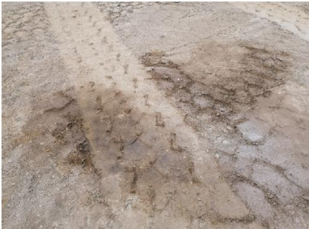
Figura 44 – Derrame de óleos / Combustível
