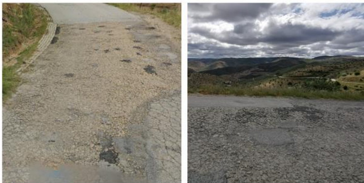
Figura 13 - EN 322 - Piso em más condições
