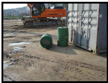
Em obra evitar que os materiais contaminados estejam espalhados pelo chão
