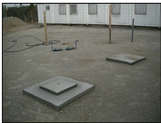
Figura 4.4 – Fossa séptica estanque para recolha das águas residuais domésticas do estaleiro
