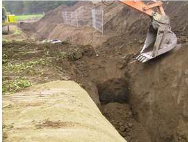
Figura 7.3.5 Trabalhos de escavação da caixa S.E. 04.2 em direcção à estaca S.E. 04.1 cx.
