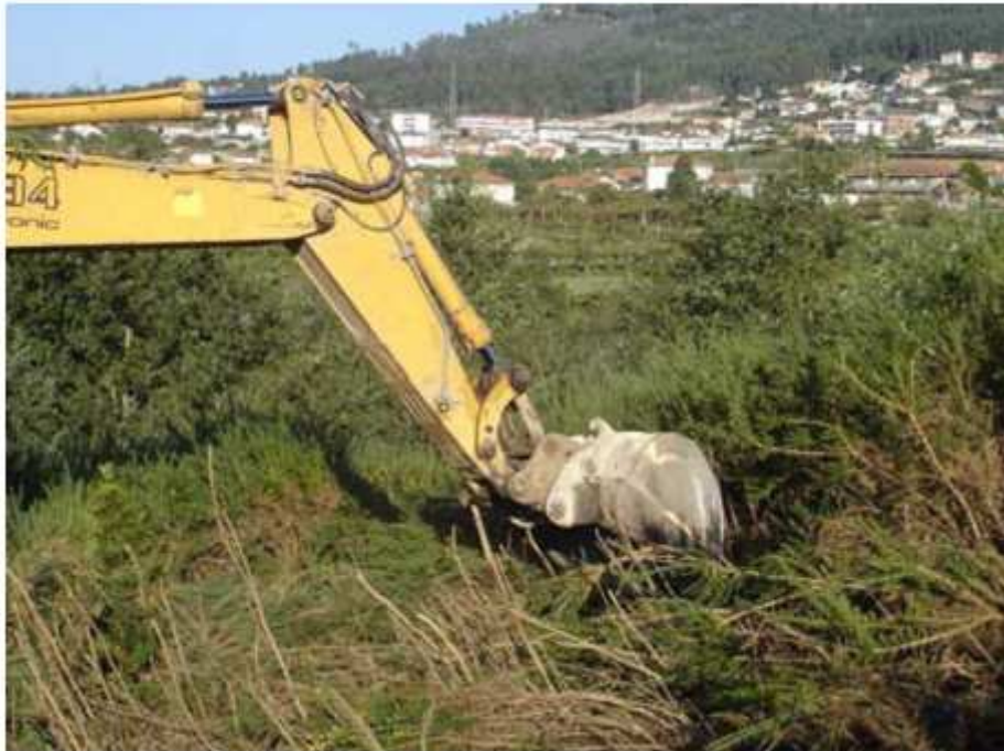
Figura 6.2.1- Trabalhos de desmatação/ desarborização e decapagem, na área de execução da ETAR de Serzedelo II.
