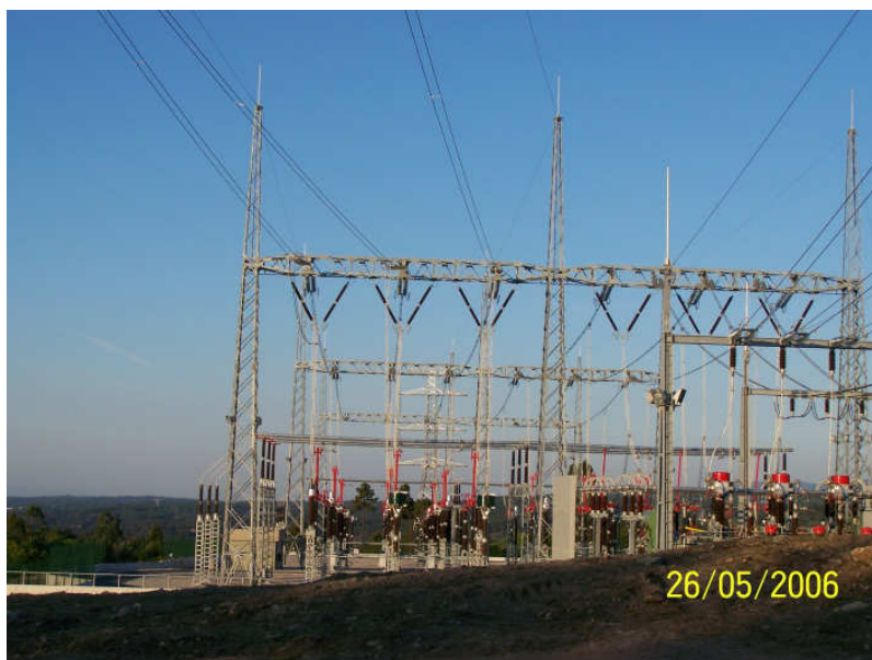
Fotografia 58 – Subestação da Valdigem
