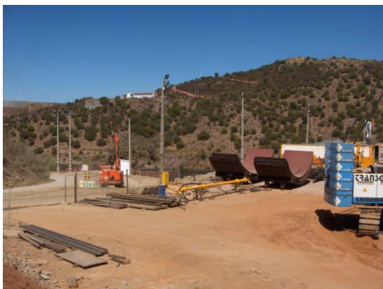
Acessos não impermeabilizados. Estaleiro do Fornecedor de Equipamentos (Agosto 2009)
