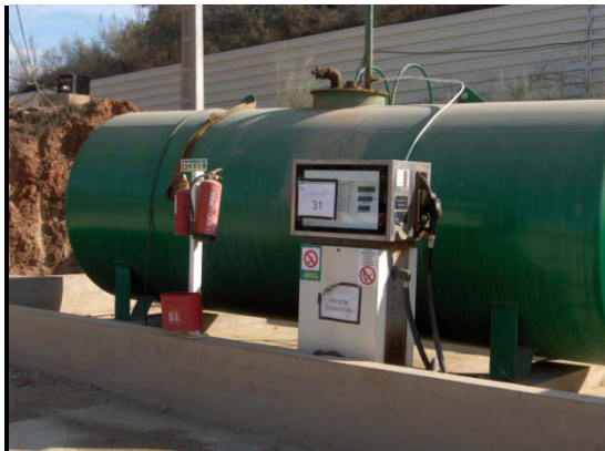
Bacia de contenção de derrames do depósito de combustível (Outubro 2009)
