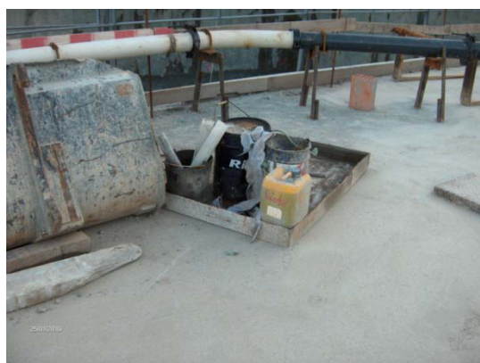
Bacia de contenção de derrames em frente de obra. Pormenor (Janeiro 2010)
