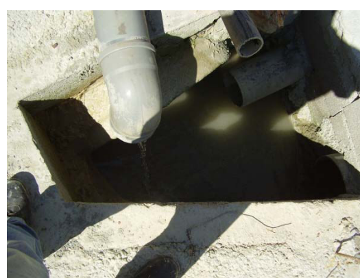
Caixa de visita da descarga final dos Tanques de Decantação (Julho 2010)
