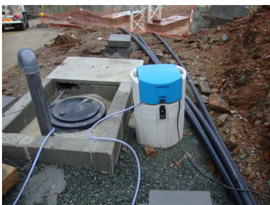
Controlo analítico dos tanques de decantação dos efluentes de escavação (Janeiro 2010)
