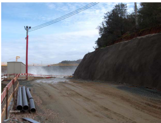
Acessos não impermeabilizados. Estaleiro da Construção (Janeiro 2010)
