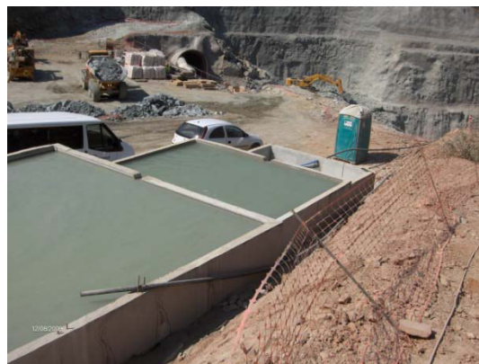
Tanques de Decantação para os Efluentes da Escavação Subterrânea (Agosto 2009)
