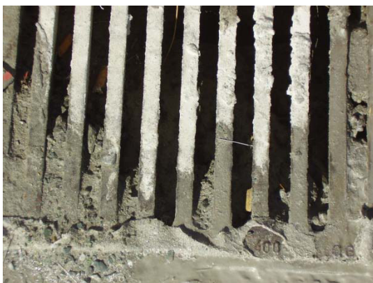
Grade de bacia de decantação de águas pluviais (Julho 2010)
