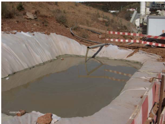
Bacia de decantação de frente de obra (Agosto 2009)
