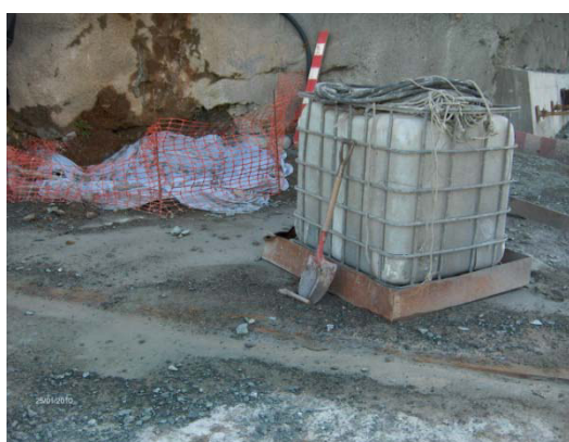
Bacia de contenção de derrames em frente de obra. Pormenor (Janeiro 2010)
