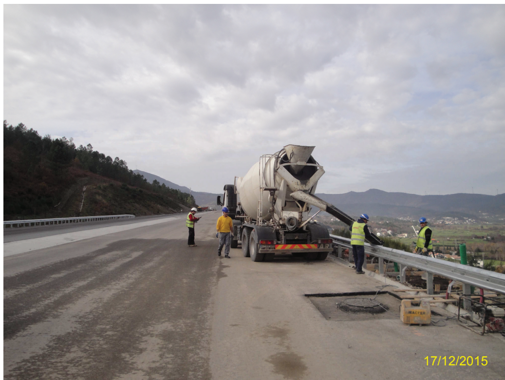
Registo Fotográfico 2 – Sapatas de Sinalização ao Pk 22+100
