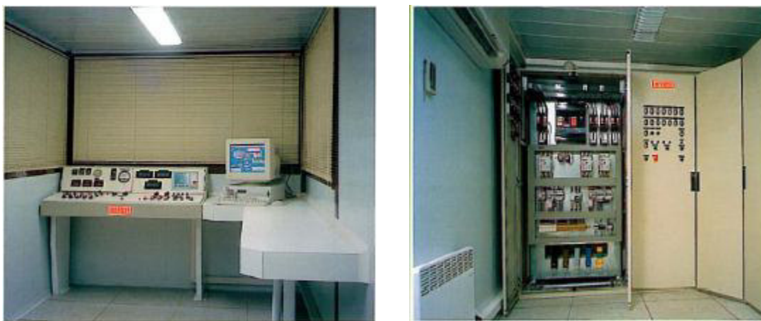
Figura 1-Aspecto interior da cabine de comando
