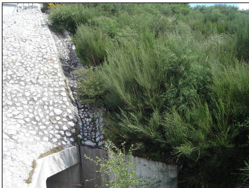
Figura 3.12 – Ponto de recolha 12 – Km 4+967, descarga próxima de um poço.
