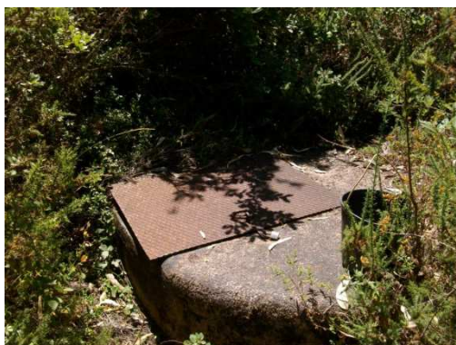
Figura 3. 2 – Ponto de recolha P1 – Poço
