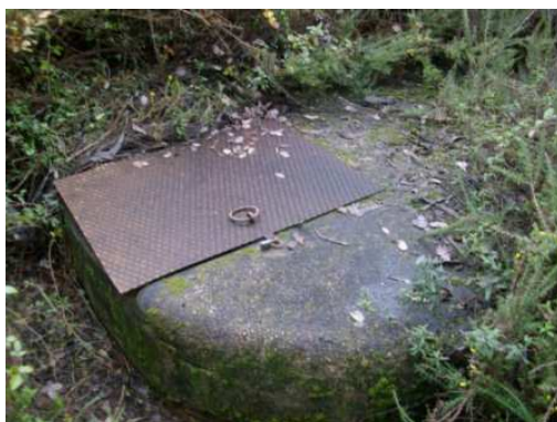
Figura 3. 2 – Ponto de recolha P1 – Poço
