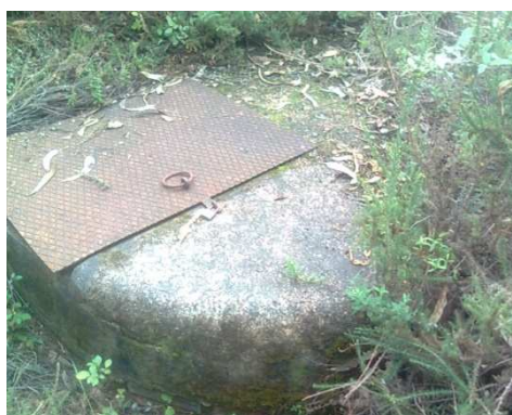
Figura 3. 7 – Ponto de recolha P1 – Poço
