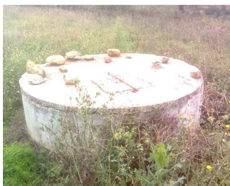
Figura 3.12 – Ponto de recolha P6 – Poço
