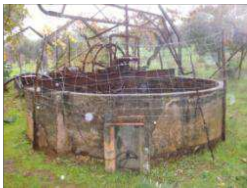
Figura 3. 1 – Ponto de recolha P0 – Poço
