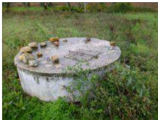
Figura 3.7 – Ponto de recolha P6 – Poço
