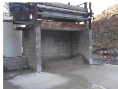
Figura 2 – Sistema de tratamento de águas residuais (filtro-prensa) do Túnel de Desvio Provisório de Daivões para o qual foi emitida Não Conformidade
