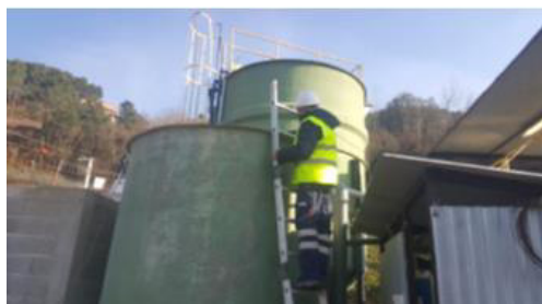
Figura 1 – Visita técnica de empresa especializada para verificação do controlador, doseador de ácido e sonda de pH da ETAL associada ao ponto de descarga PV1
