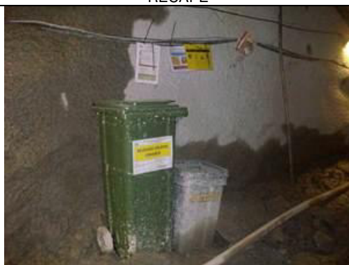
Figura 5 - Disponibilização de kit de emergência ambiental no interior do túnel do bifurcador superior
