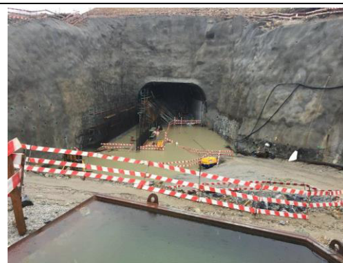
Figura 4 – Inundação ocorrida na Tomada de Água do AHGV em 11/12/2017
