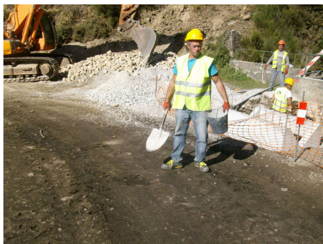
Figura 4 – Tratamento de pequeno derrame (recolha de solo contaminado) no Acesso B12 a 12 de setembro de 2017
