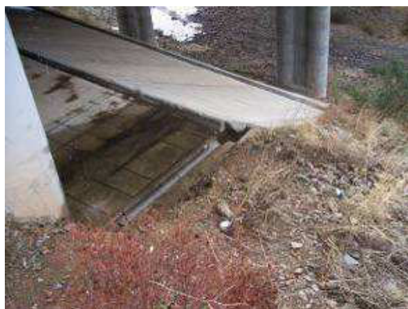
Fotografia 10 – Rio Mira – Escorrências
