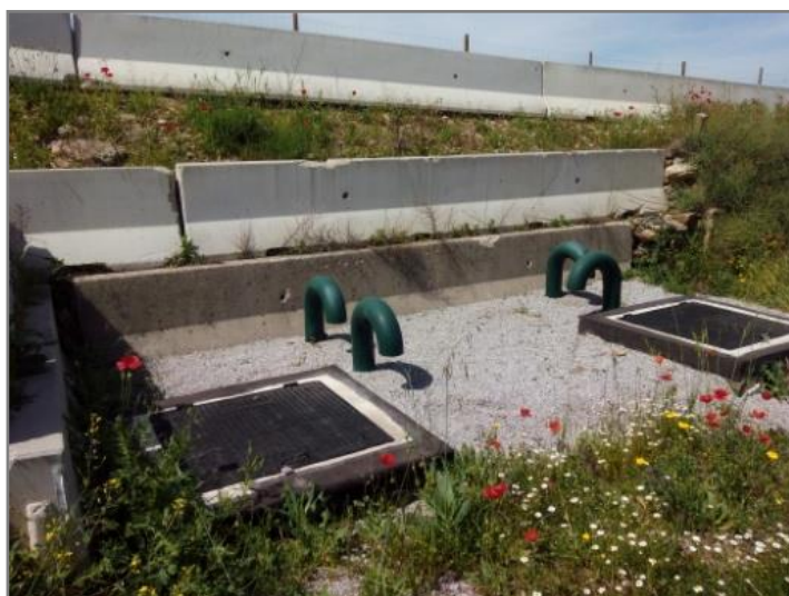
Figura 3.20 – P2, Captação Pública n.º 2, ao km 6+150, do lado esquerdo da via.
