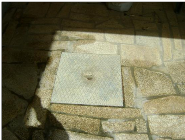
Figura 3.15 – Furo localizado ao km 0+150 do Ramo C do Nó de Vila Real Sul
