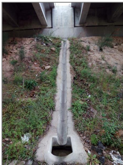
Figura 3.7 – Ponto de descarga das águas de escorrência da plataforma, localizado ao km 5+975.
