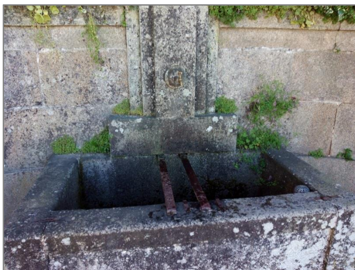
Figura 3.10 – Mina nº 9, localizada ao km 0+325, sob o tabuleiro do viaduto do rio Corgo entre os pilares localizados aos km 0+311 e 0+371.
