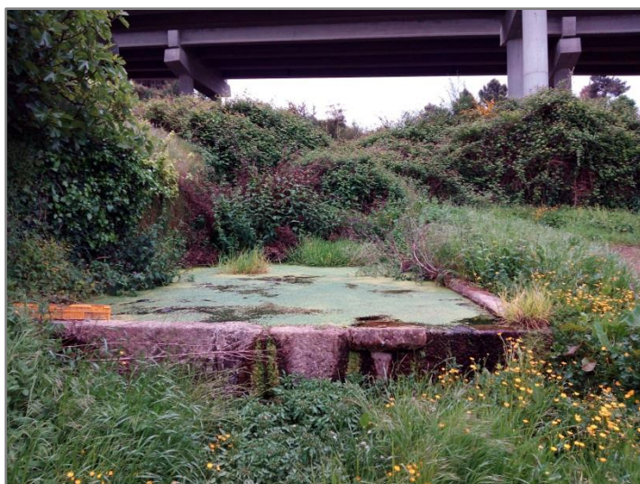
Figura 3.12 – Mina localizada ao km 5+125 sob o tabuleiro do viaduto da Quinta das Presas entre os pilares existentes ao km 5+101 e 5+13.
