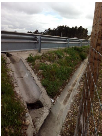
Figura 3.8 – Ponto de descarga das águas de escorrência da plataforma, localizado ao km 9+475.
