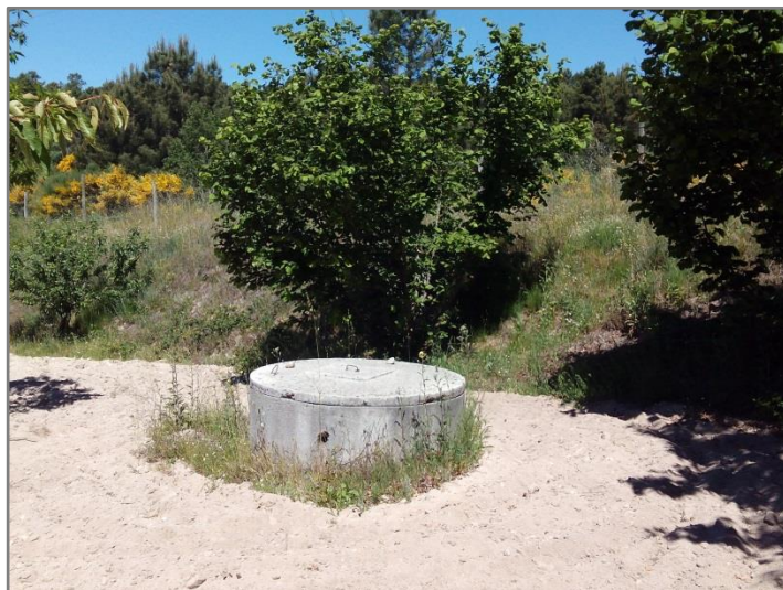
Figura 3.8 – Poço nº78, localizada ao km 2+900, do lado direito da via.
