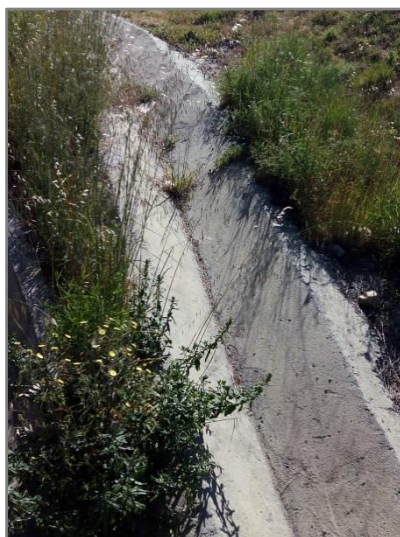
Figura 3.5 – Ponto de descarga das águas de escorrência da plataforma, localizado ao km 6+520, do lado esquerdo da via.
