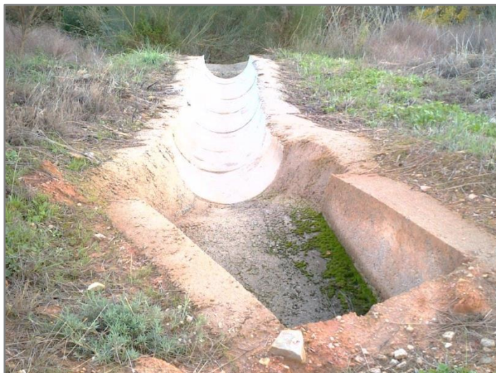
Figura 3.10 – Ponto de descarga das águas de escorrência da plataforma, localizado ao km 6+886 (PH 6-6).
