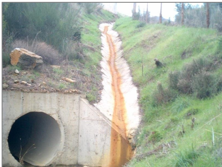
Figura 3.11 – Ponto de descarga das águas de escorrência da plataforma, localizado ao km 9+269.
