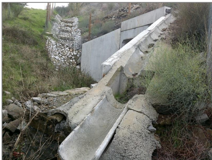
Figura 3.12 – Ponto de descarga das águas de escorrência da plataforma, localizado ao km 10+116 (PH 10-2).
