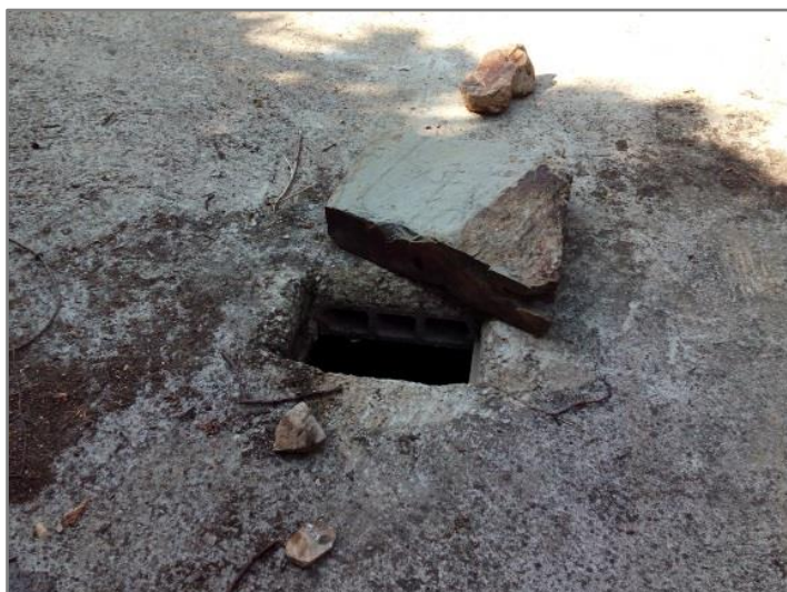
Figura 3.14 – P2, Poço nº16.
