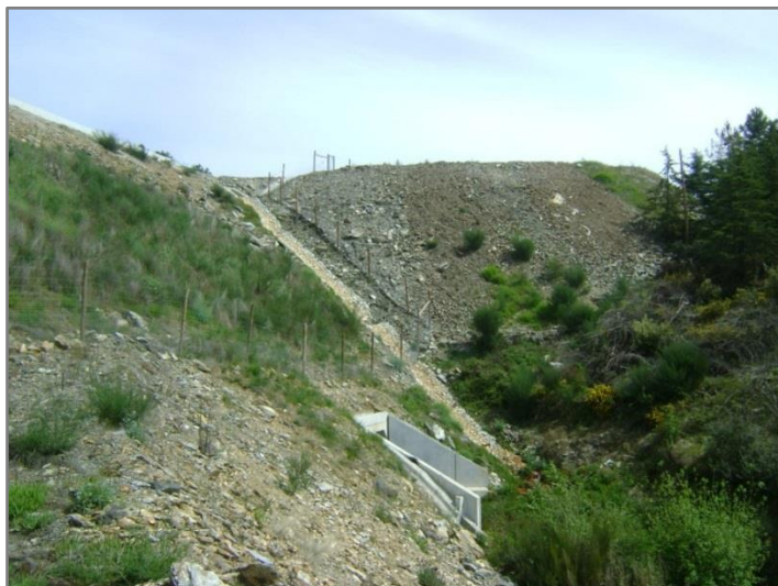
Figura 3.9 – Ponto de descarga das águas de escorrência da plataforma, localizado ao km 3+776.
