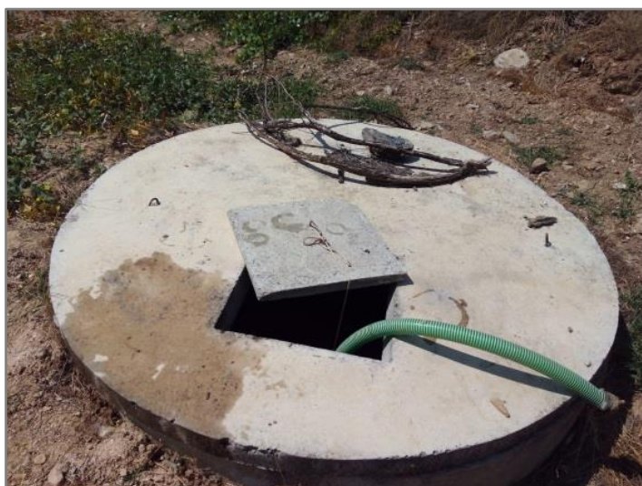
Figura 3.13 – P1, poço nº3.
