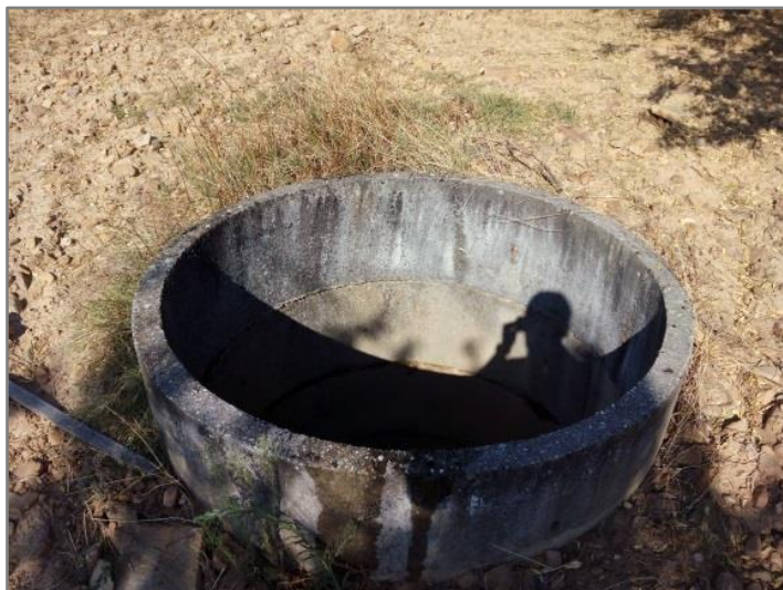
Figura 3.16 – P4, Poço nº 31.
