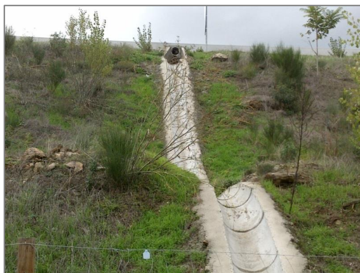
Figura 3.10 – Ponto de descarga das águas de escorrência da plataforma localizado junto à linha de água restabelecida pela PH 3-3 ao km 3+372.
