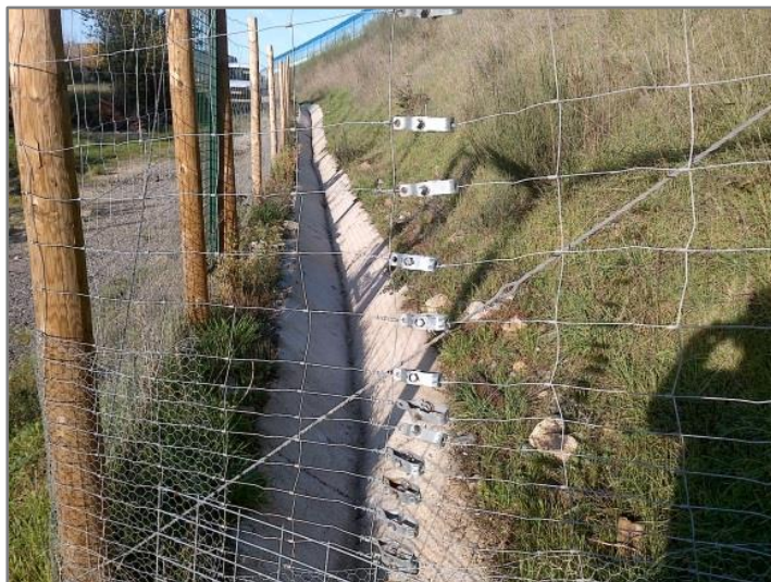
Figura 3.12 - Ponto de descarga das águas de escorrência da plataforma ao km 14+101.
