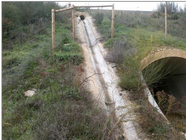
Figura 3.11 - Ponto de descarga das águas de escorrência da plataforma ao km 9+125.
