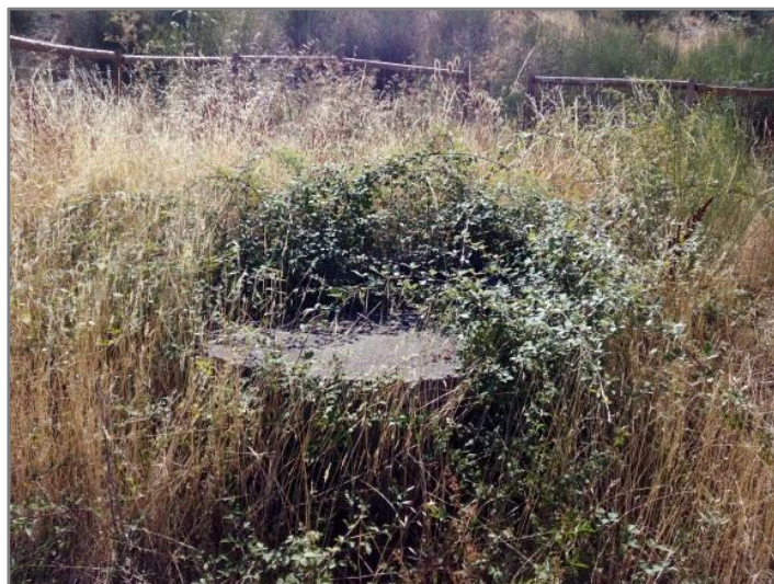
Figura 3.18 – P6, Poço nº 31, ao km 13+025, do lado esquerdo da via.
