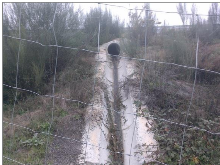
Figura 3.9 - Ponto de descarga das águas de escorrência da plataforma ao km 2+074.
