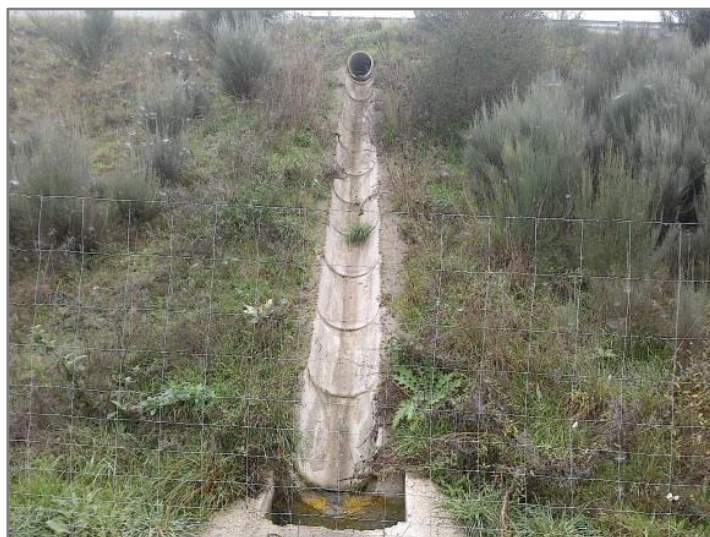
Figura 3.10 - Ponto de descarga das águas de escorrência da plataforma ao km 5+125.
