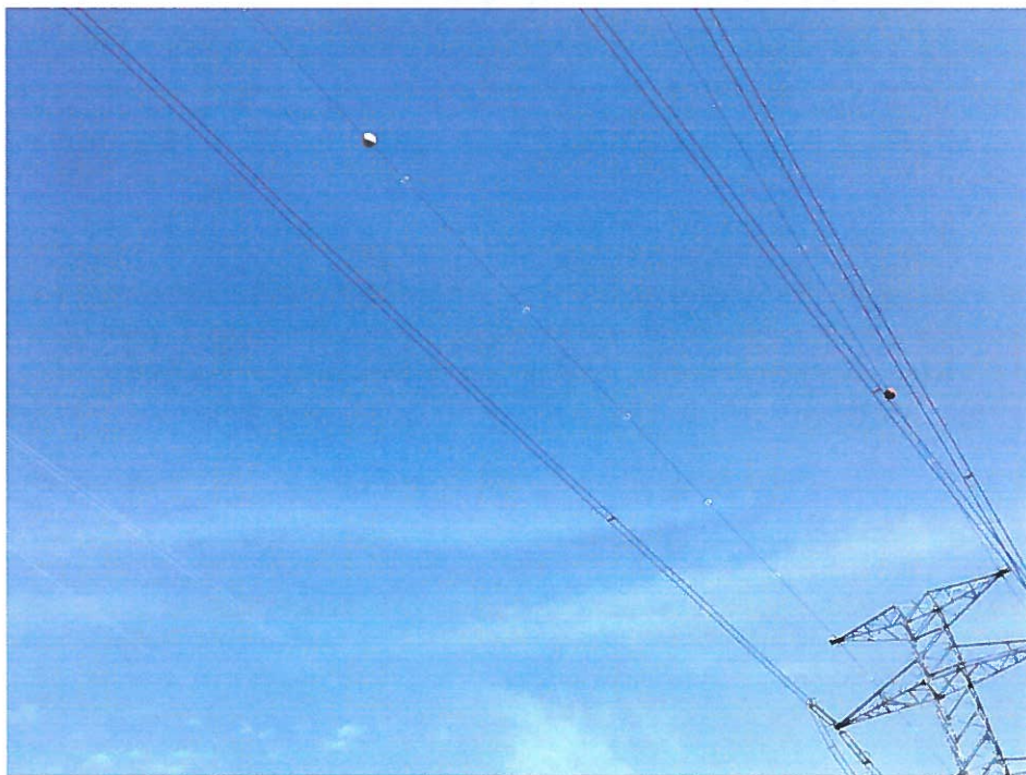
Fotografia 3 – Presença de BFD no vão P35-P36
