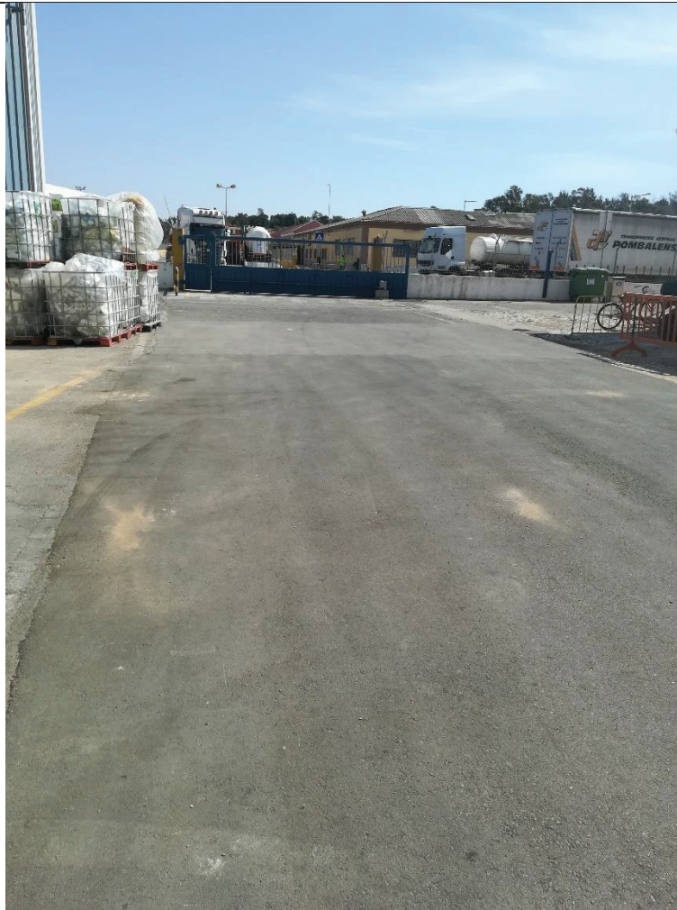
Aspetto do pavimento reparado em fevereiro de 2020 à data da auditoria (10.09.2020)
