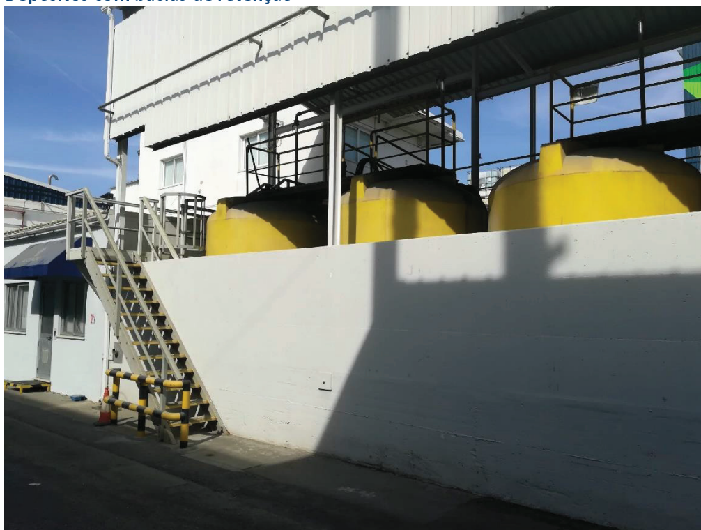
Depósitos com bacias de retenção
