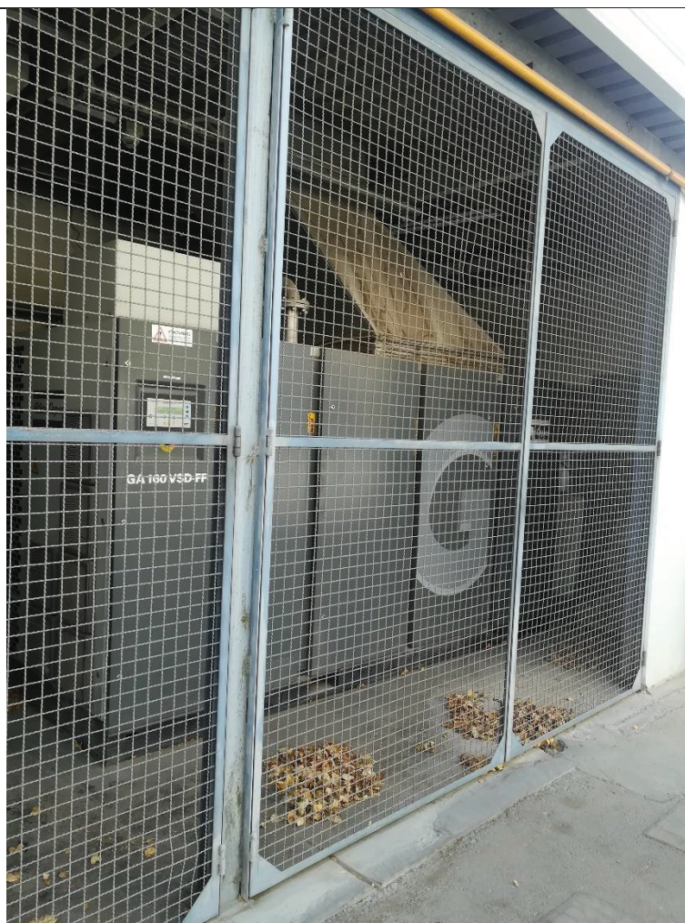
Sala de compressores
