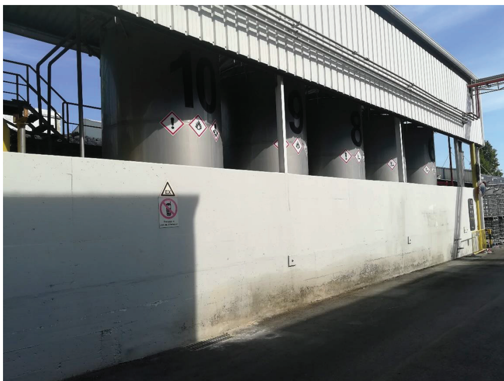
Depósitos com bacias de retenção
