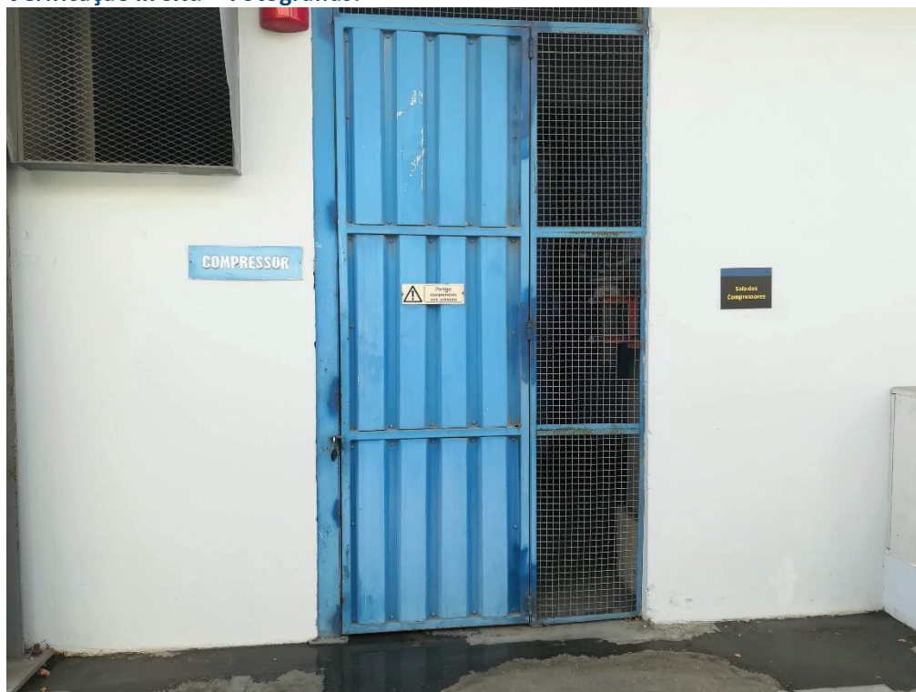
Sala de compressores
