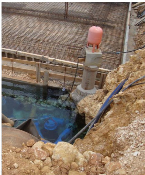
Foto 8 – Bombas submersíveis para retirar água do Tanque de Equalização
