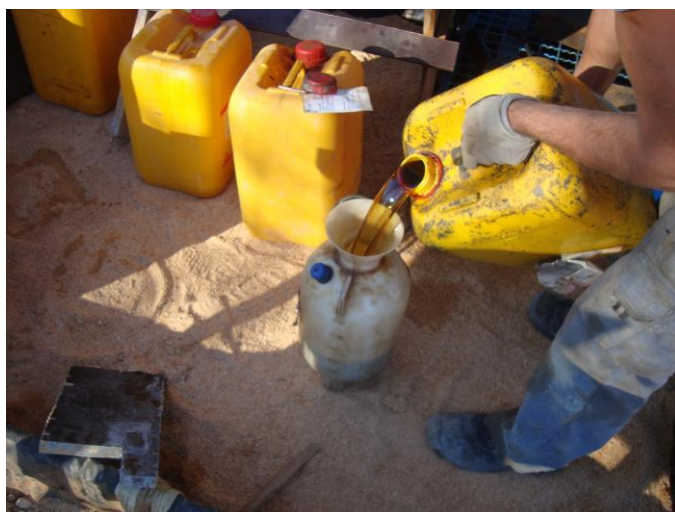
Foto 26 – Trasfega de produto dentro da bacia de retenção
