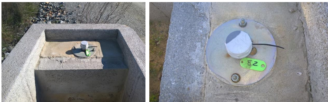
Fig.8 - Aspecto geral de um extensómetro.
