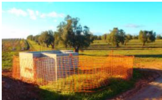
Figura 13 – Redes Laranja / Guarda-corpos existentes na rede rega
