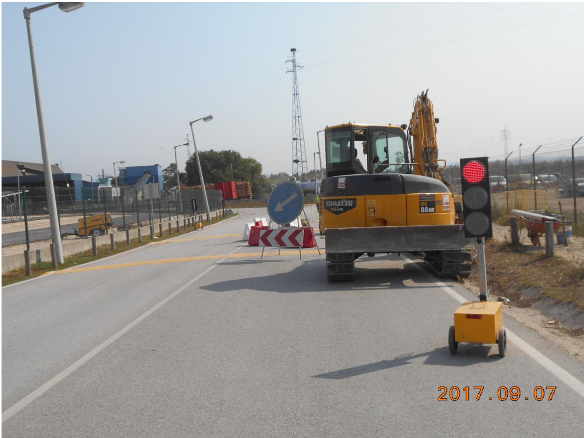
Evidência do cumprimento da Medida de minimização n.º 22 e 23 – sinalização de obras na via pública e caminhos em boas condições
