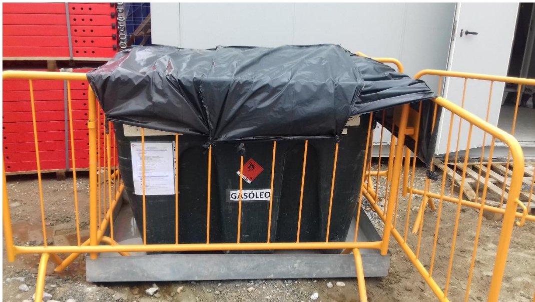
Evidência do cumprimento da Medida de minimização n.º 27 – abastecimento de gásóleo com bacia de retenção
