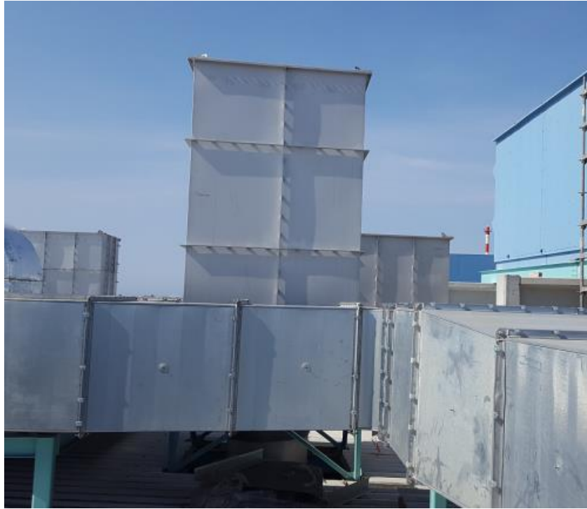
Evidência do cumprimento da Condicionante n.º 10 – Instalação dos silenciadores nas tubagens de exaustão
