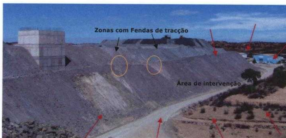
Figura 2 - Localização das zonas com fendas de tracção e área de intervenção.
