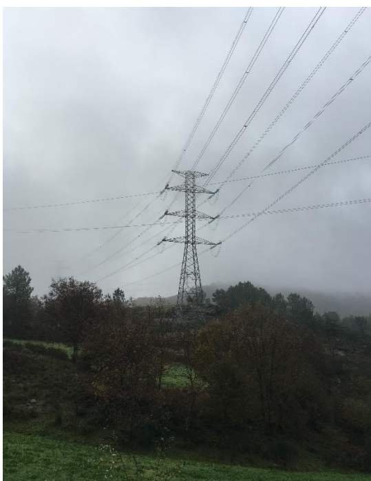
Figura 4.3 – Apoio da Linha Dupla Ribeira de Pena – Vieira do Minho 1/2, a 400 kV
