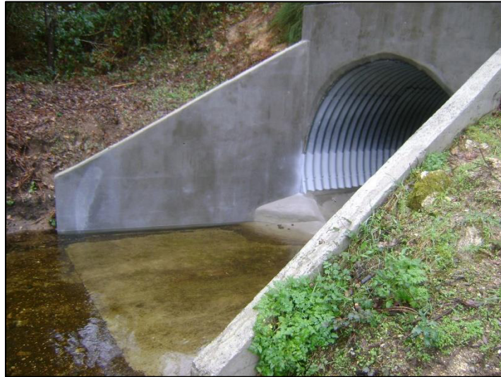
Figura 4 – Lote 4 - S2M - Ribeira do Farreco, PK 7+000, a montante da via
