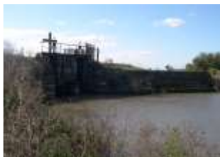
Figura 4 – Comporta de maré
