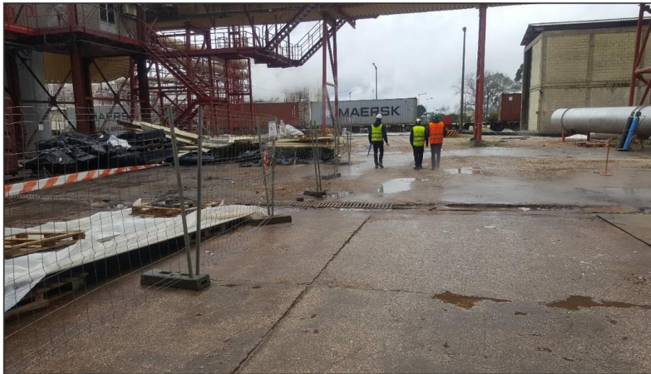
Foto 3.3 – Zona onde serão instalados os equipamentos auxiliares como silo diário, filtro de mangas, entre outros
