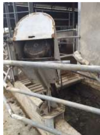
Figura 3.12 – Tanque de receção de chorume com homogeneizador
