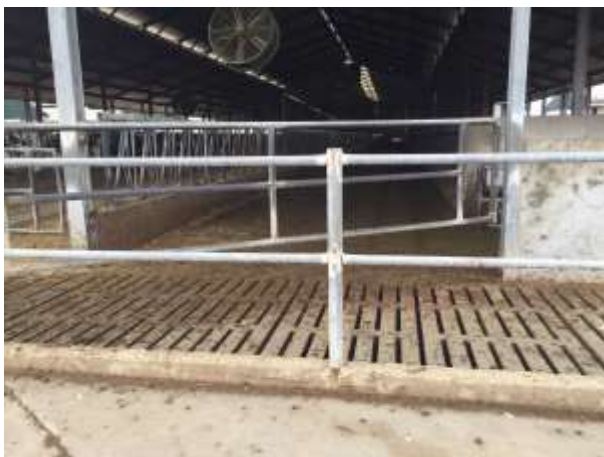
Figura 3.11 – Grelha de drenagem de chorume
