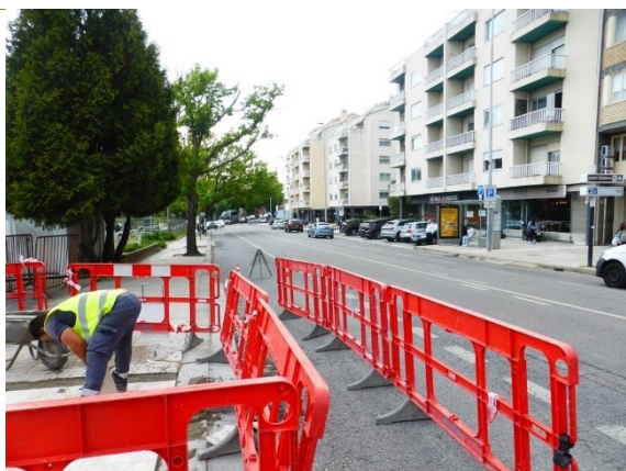
Rua do Campo Alegre, com obras e condicionamento de uma parte do parque de estacionamento. Área de ocupação temporária.
