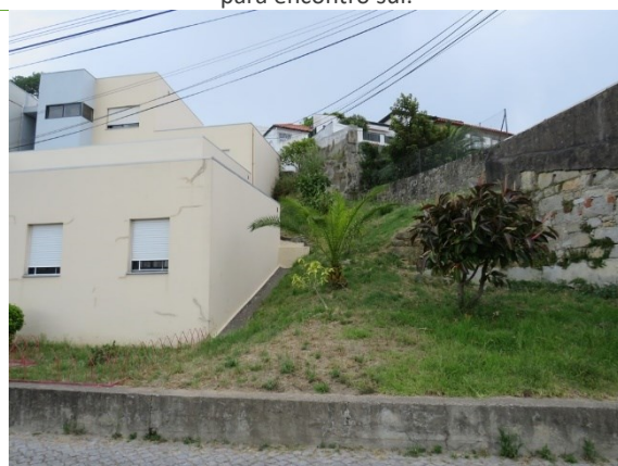
Detalhe do limite nascente dos edifícios da Cooperativa de Massarelos, com fissuras nas fachadas.
