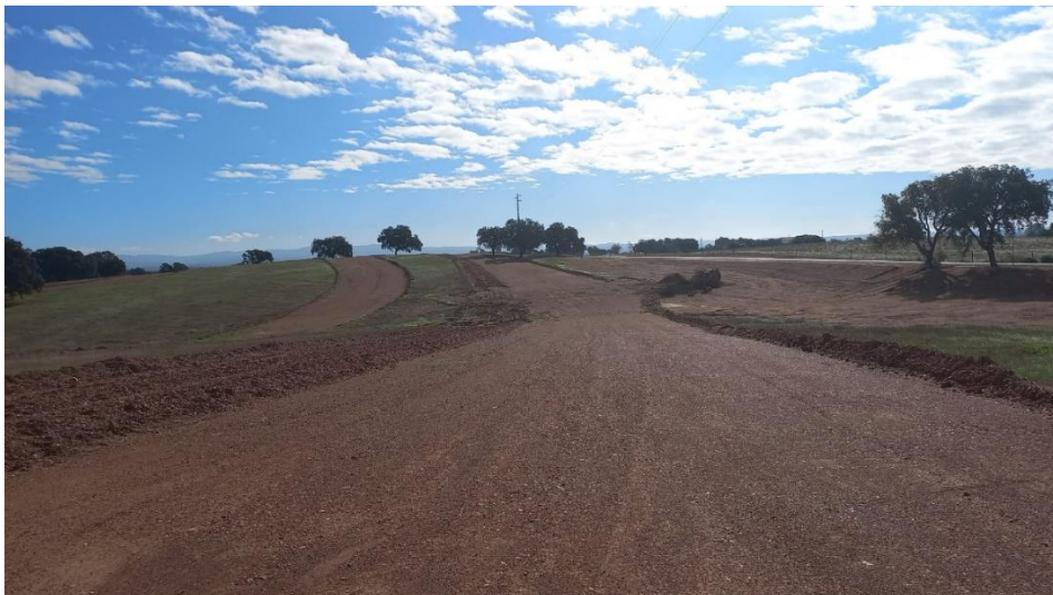
Fotografia 3.7 – Intervenções executadas indevidamente pelo Promotor no terreno para implantação do Projeto "Circuito do Sol" – traçado de ampliação da pista
