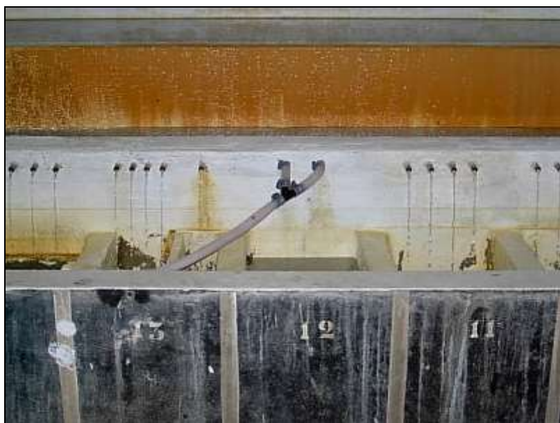
Fotografia 21 – Bicas de Água no Interior do Repartidor da Presa Nova
