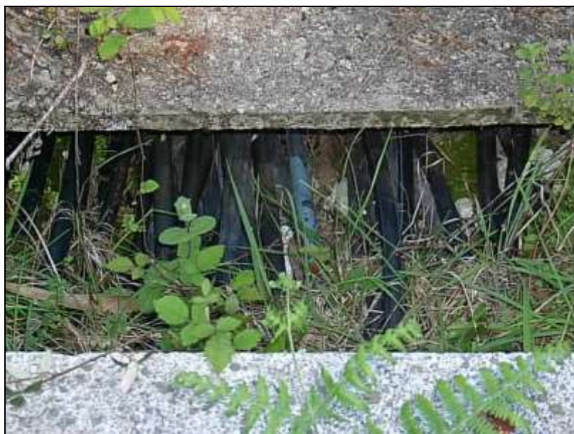
Fotografia 22 - Conduatas que saem do Repartidor da Presa Nova
